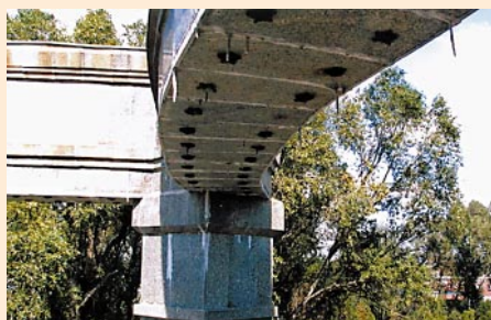
Fot. 3. Nacieki wapienne pod belką wieńczącą (sople)
