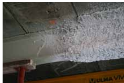
Belka stalowa niezabezpieczona (z lewej) oraz zabezpieczona (z prawej) przed działaniem ognia (fot. Marek Łużyński)
